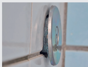
La buse est en biais dans la paroi du bassin
