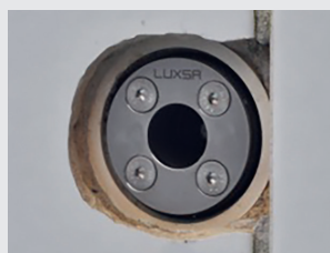
Élément de base de la buse installé dans le filetage défectueux
