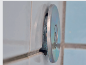
La bocchetta è inclinata rispetto alla parete della piscina
