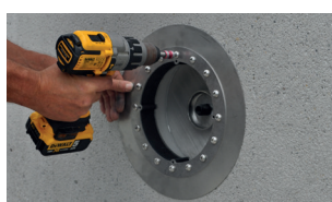
3. Serrare l'elemento base, effettuare il montaggio solo dopo la riprofilatura delle pareti
