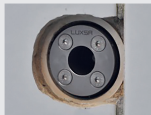
Elemento base della bocchetta montato nella filettatura rotta
