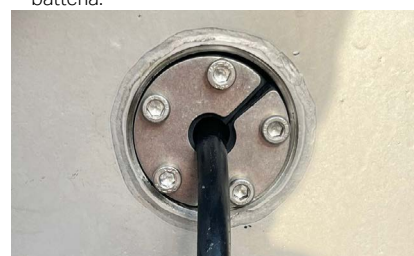
4. Passaggio del cavo 100% a tenuta stagna
